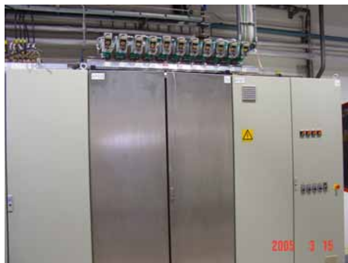
制冷剂泄漏检测系统
