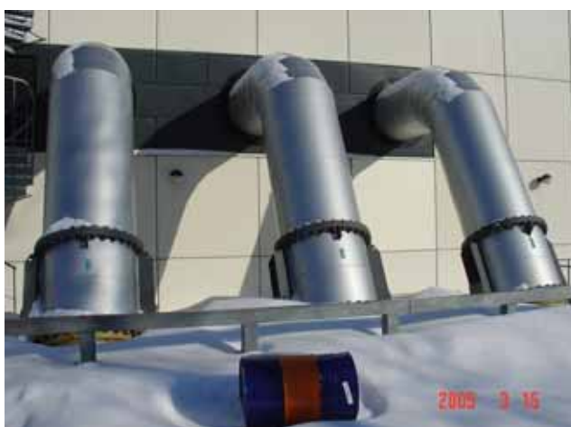
Ropsten1,2 号站海水泵站引入热泵站的 6 条海水引入管道中的 3 条
